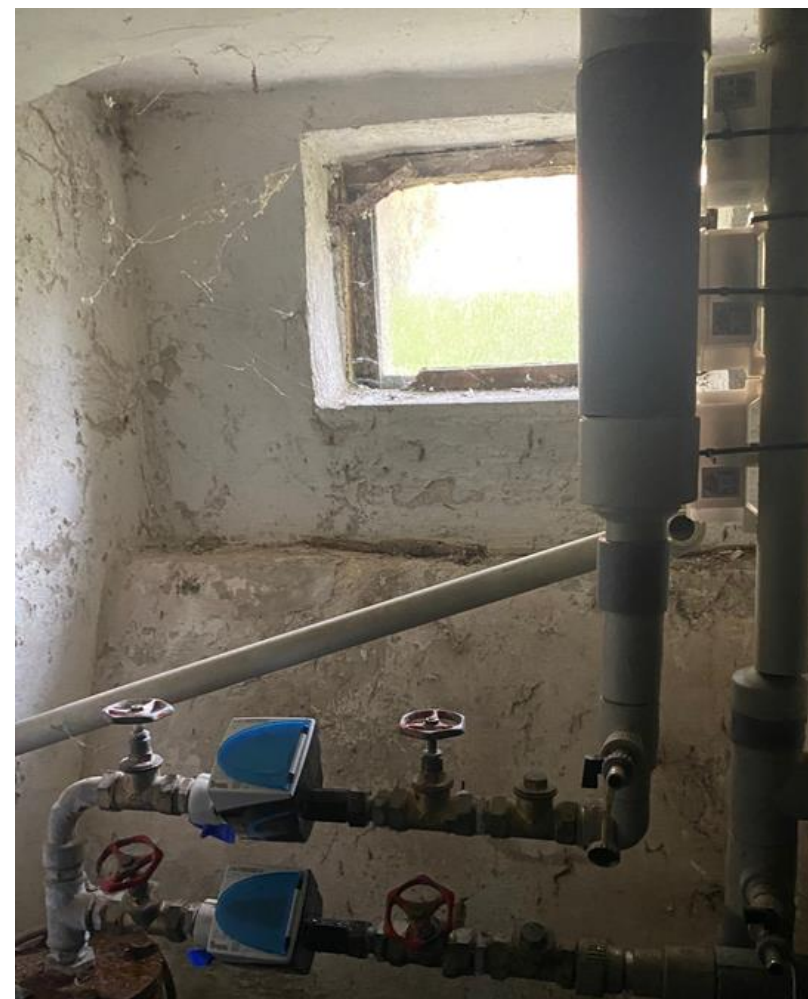
... instalované vodoměry a smart pointy.
